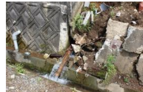
損傷した擁壁より噴出する水 43
