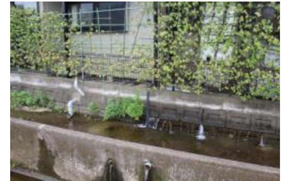
埋設管の損傷によってブロック擁壁の隙間から排水される水
