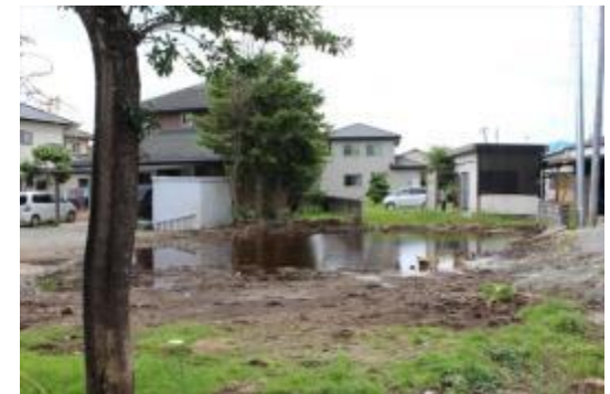
排水施設の損傷により地表面にできた水たまり
