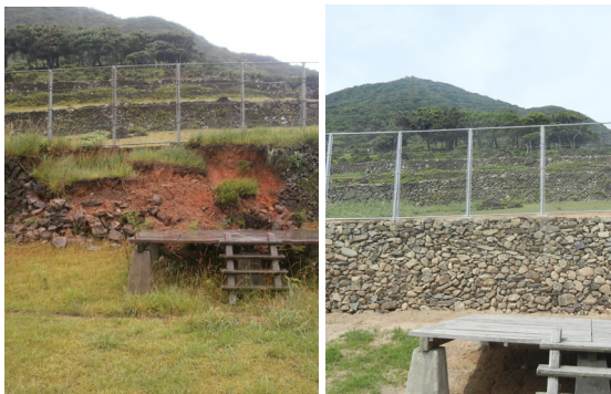
写真-9 被災状況 (左) と復旧状況 (右)
