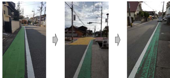
図1 カラー舗装の劣化状況
